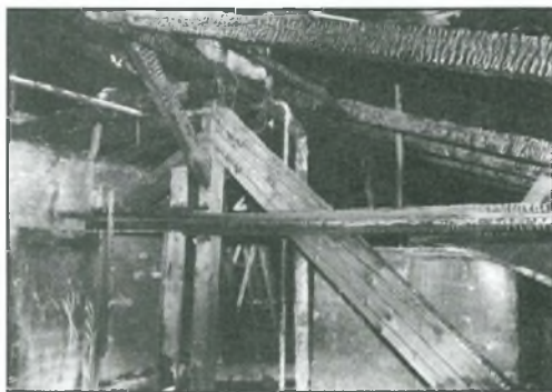
Najwyższa kondygnacja szpitala po pożarze.
