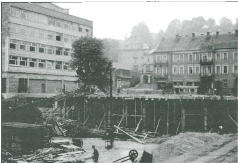
Nadzorowana przez WSSE budowa budynku przychodni zdrojowej w Krynicy. Zdjęcie z września 1968 r. wykonane przez przebywającego na kontroli w Krynicy docenta Mieczysława Bileka. (Ze zbiorów Macieja Bileka)
