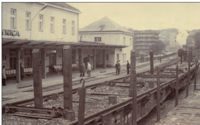
Rok 1986. Przebudowa układu torowego stacji Krynica. Ty2 manewrujący na torach stacji Krynica, a na pierwszym planie zespół platform do transportu długich szyn. Fot. ze zbioru PLK S.A. ZLK Nowy Sącz
